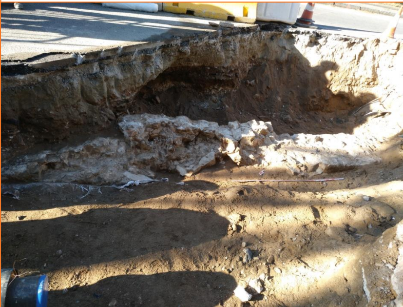
Foto 122. Vista de la cara interna del mur UE 148 (MR 6) afectada per la construcció del col·lector de 1992 (UE 18).
