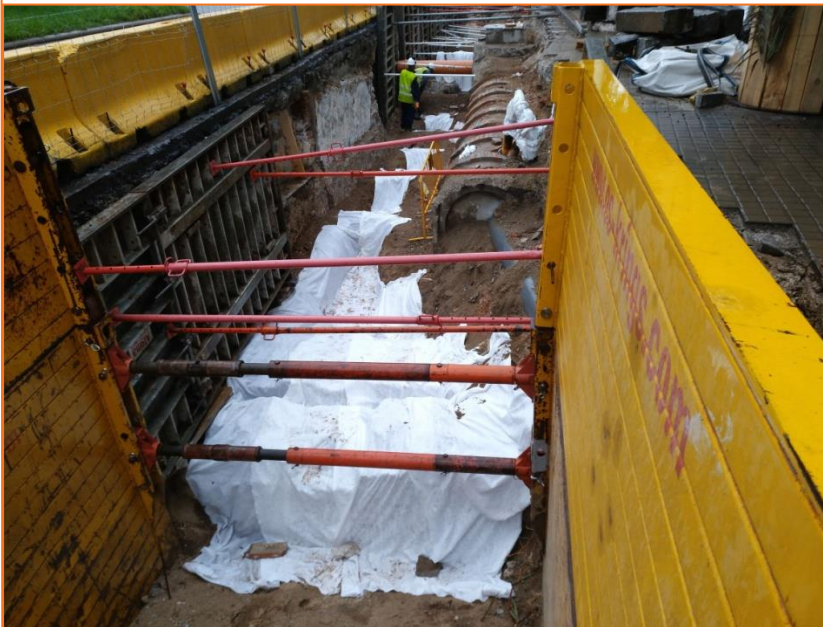
Foto 138 Vista de les estructures de l'ala sud del fort tapades amb geotèxtil abans del rebliment.
