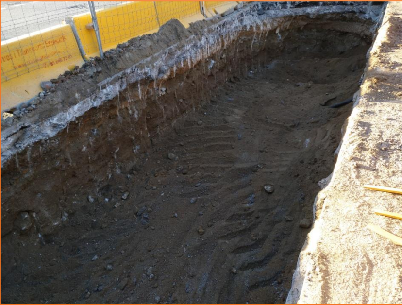
Foto 65. Vista de la rasa de l'Avinguda del Litoral en l'encreuament amb el carrer de Ramon Trias i Fargas.
