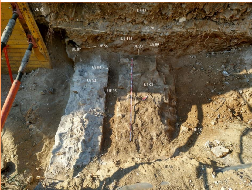
Foto 72. Vista de l'edifici del segle XX i la seva afectació al mur de tancament (MR 1) de l'ala sud del fort de don Carlos.
