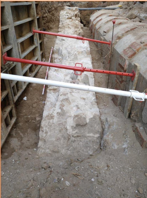
Foto 88. Vista del coronament de UE 104 (MR 3) arrassat durant l'Exposició Universal de 1888 (UE 90) i afectat per la construcció del col·lector (UE 18).
