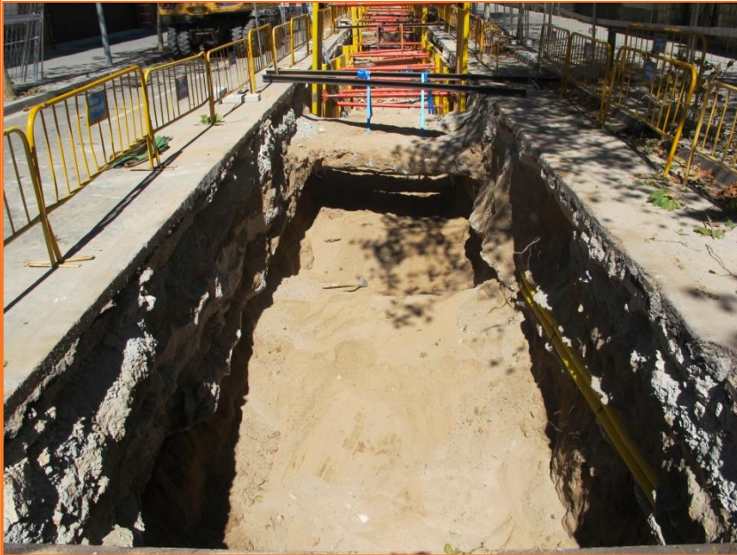
Foto 43. Vista de la rasa del carrer d'Àvila després del desmuntatge de les estructures UE 32, 27, 50 i 54.
