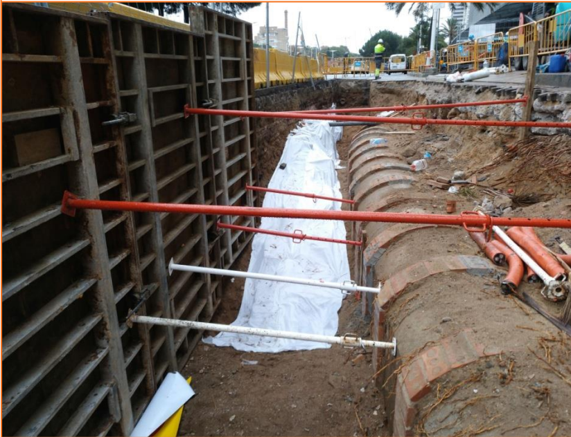
Foto 139. Vista de les estructures de l'encreuament sud del camí a cobert de la ciutadella amb el fort de Don Carlos tapades amb geotèxtil abans del rebliment.
